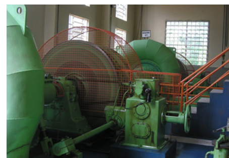
Francis turbines Usina Fortaleza.
